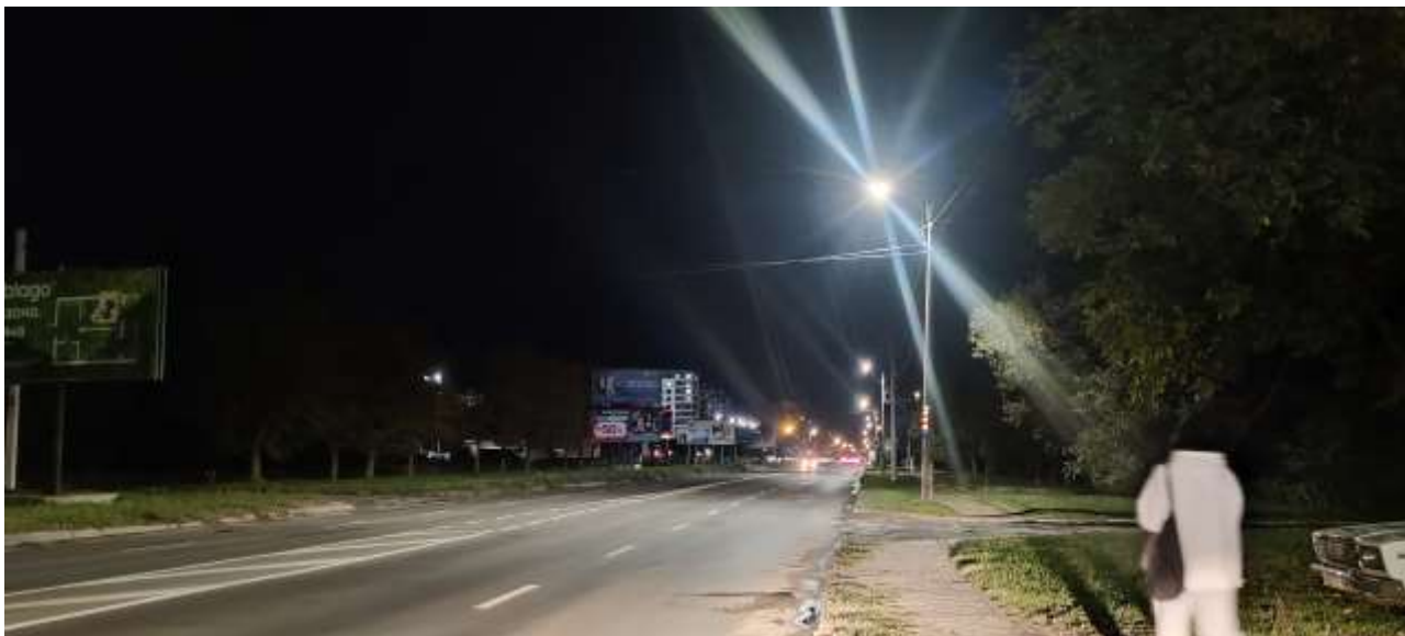
Освітлення вул. Надрічна (від вул. Вовчинецька до вул. Хмельницького)
